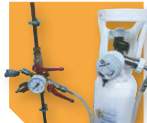
Alimentation du réseau avec bouteille de secours
